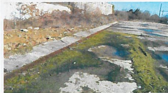
Réseaux / caniveau déchargeant dans le séparateur d'hydrocarbures
